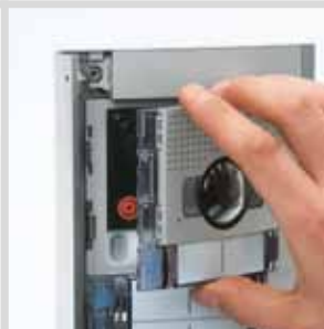
3 Opening van de klemmen en front verwijderen
